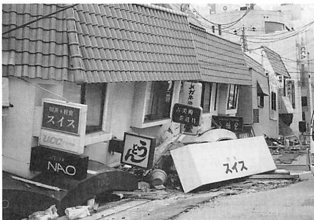
写真・1 1階間口に耐力壁がない店舗併用住宅は軒並み倒れた
