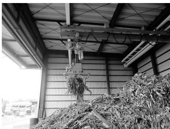
▲写真⑤ 燃料投入用ロボット
