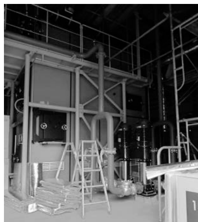
◀写真② 木質焚きボイラー
